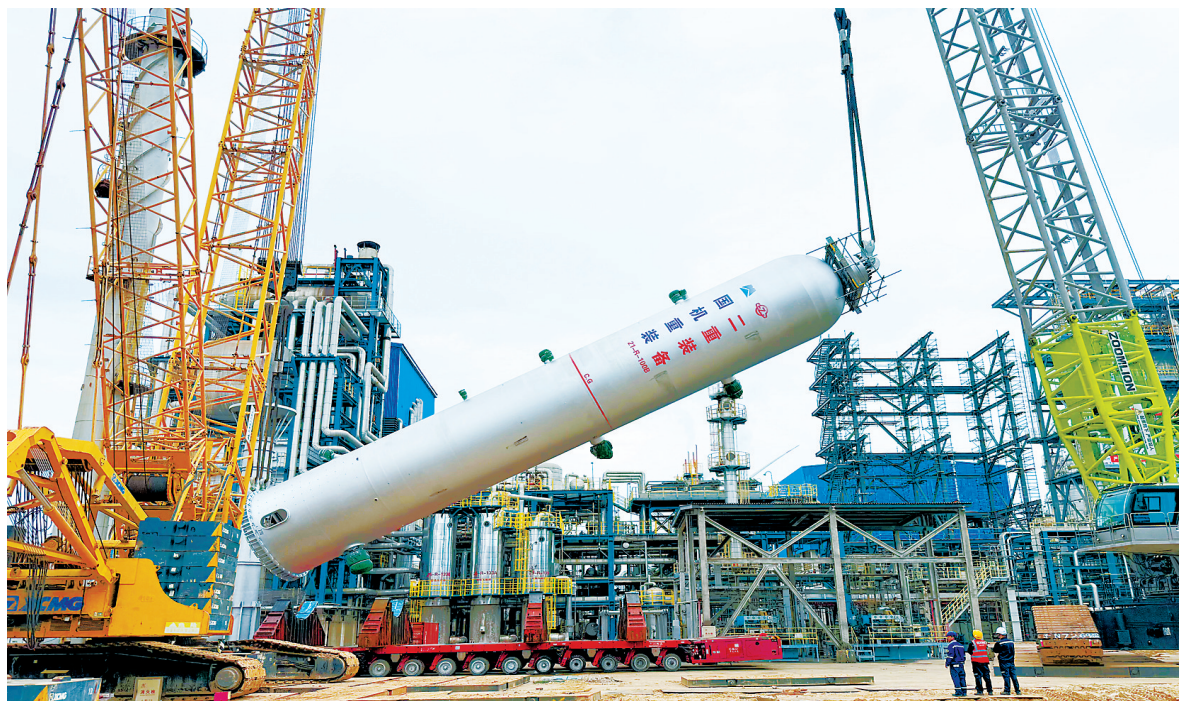
5月22日至24日,福海创芳烃装置优化节能改造项目取得关键进展,加氢裂化装置两国国产化精制反应器分批精准吊装就位,标志着项目核心重型设备安装完成里程碑突破,顺利打通工程建设关键节点。本次吊装的精制反应器为项目核心国产化装备,单台重达545.3吨,规格Φ4013×30210mm,是加氢裂化装置改造的关键主力设备。
